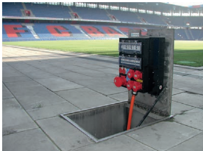
Unterflurelektrant, St.Jakob-Park in Basel
